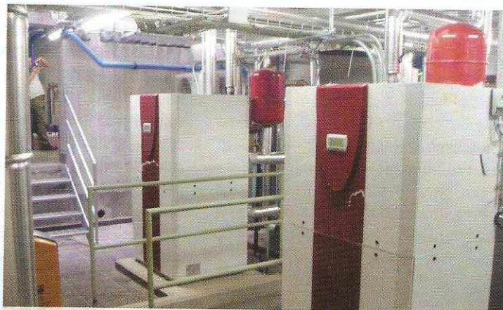
Foto 2 - Sala tecnica telegestita in controllo remoto con pompe di calore geotermiche, adibita a una palazzina di venti appartamenti (fonte E.GEO S.p.A.)
